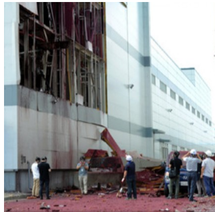
(b) 외벽 붕괴 사진
