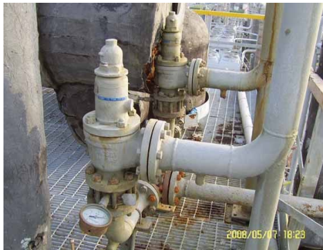
(a) 안전밸브 설치 사진
