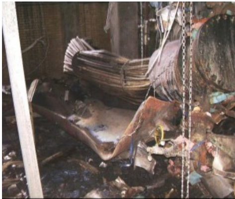
(a) 사고 발생 열교환기 사진
