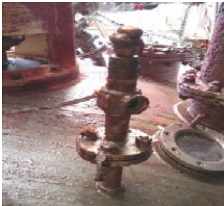
(a) 반응기에 설치된 안전밸브
